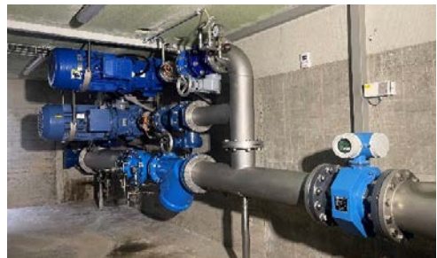
Zweite hydraulische Pumpe nachgerüstet, 2019
