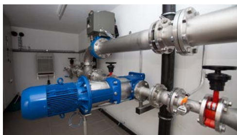
Stufenpumpwerk Weingasse, Hilfikon: Innenansicht
