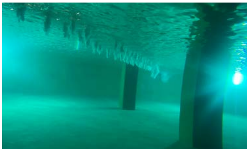
Wasserreservoir Bergmättli – kann bis zu 2000m 3 Wasser speichern, 1993
