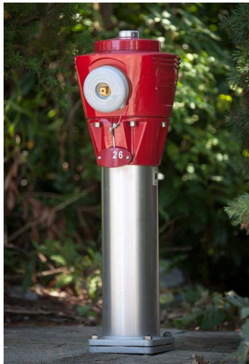
Einer der vielen Hydranten für den Löschschutz
