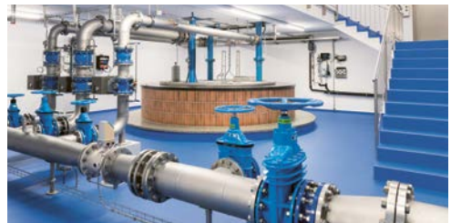
Alles erstrahlt im neuen Glanz im Pumpwerk Kreuzester, 2019
