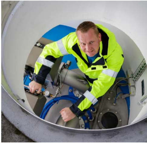
Brunnenmeister Sven Tauchert bei der Arbeit im Pumpwerk Unterzelg
