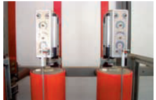
Schutzrelais MS-Anlage älterer Bauart
