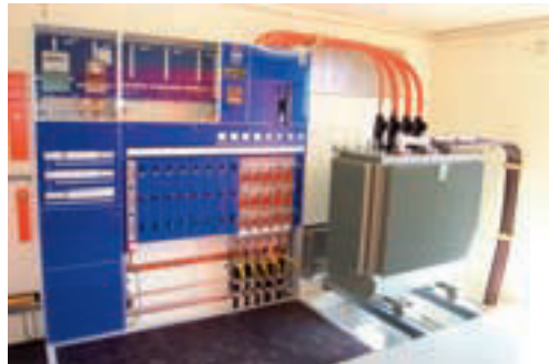
NS-Verteilung und Trafo 630kVA
