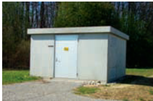
Neue Trafostation in Elementbauweise
