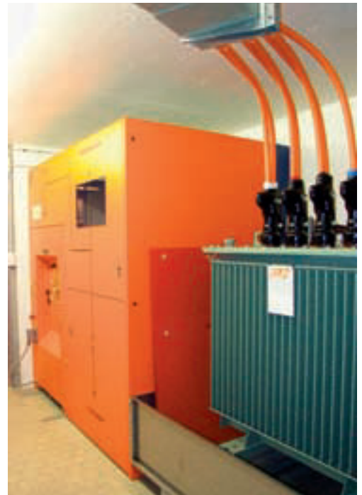
Gekapselte MS-Anlage und Trafo 630kVA
