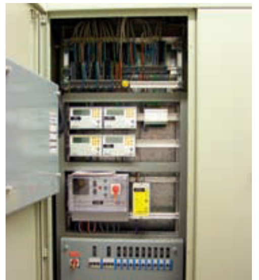
Schaltgerätekombination für Heiz-Anlage
