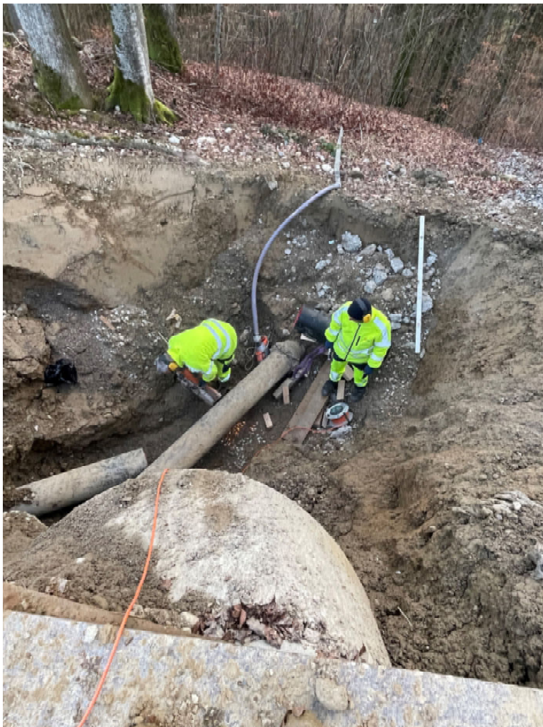
Zusammenschluss Ableitung Reservoir Bergmättli – Mario Schaad, Rohrnetzmonteur WV und Marino Jappert, Rohrnetzmonteur WV
