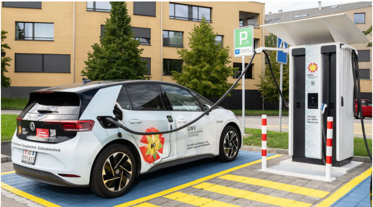
Elektromobilität Schnellladestation Dorfplatz Villmergen
