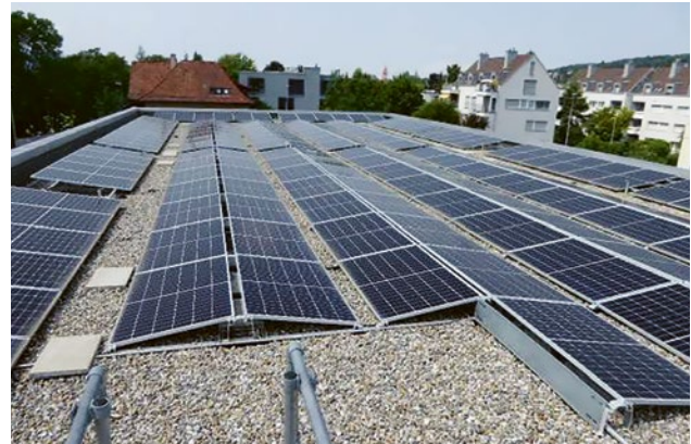
2023 wurden im Siedlungs-/Industriegebiet von Küsnacht vier Photovoltaikanlagen der Werke am Zürichsee AG mit dem Gütesiegel naturemade star ausgezeichnet. (Bild: WaZ)
